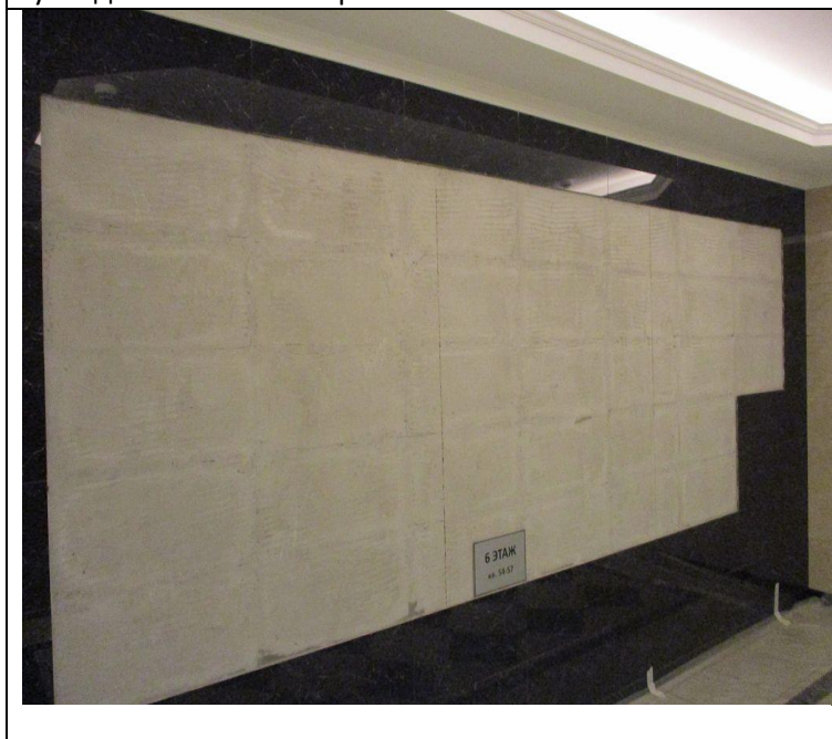
Кор.5, Сек.2, эт.6 Лифтовой холл Восстановление настенного плиточного покрытия -укладка плитки и затирка швов
