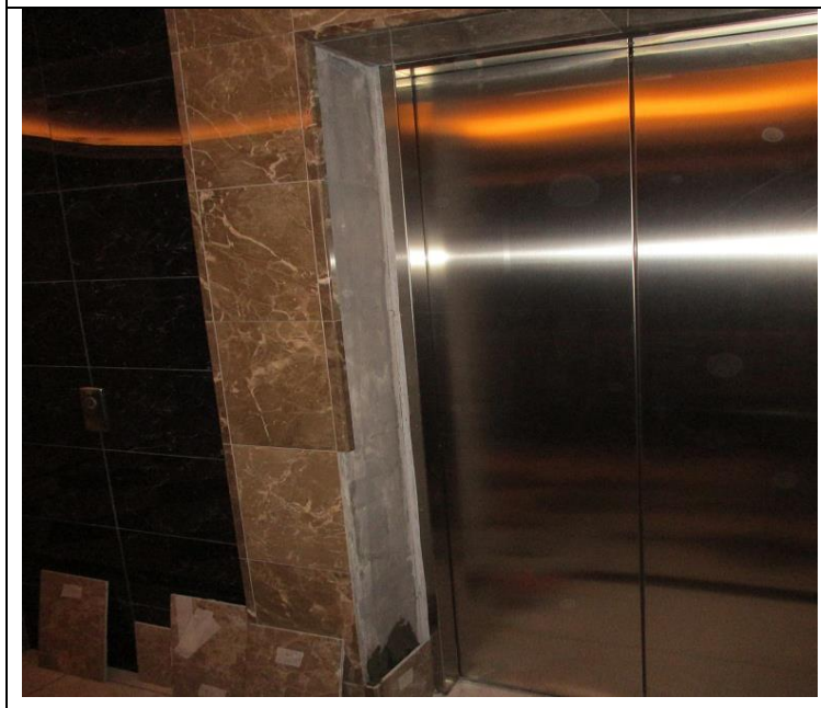
Кор.5, Сек.3, эт.11 Лифтовой холл Восстановление откосов -укладка плитки и затирка швов
