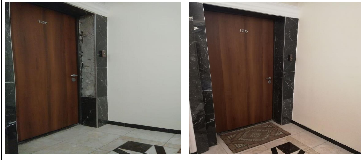
Кор.3, Сек.3 эт.12 Квартирный холл Восстановление откосов -укладка плитки и затирка швов
